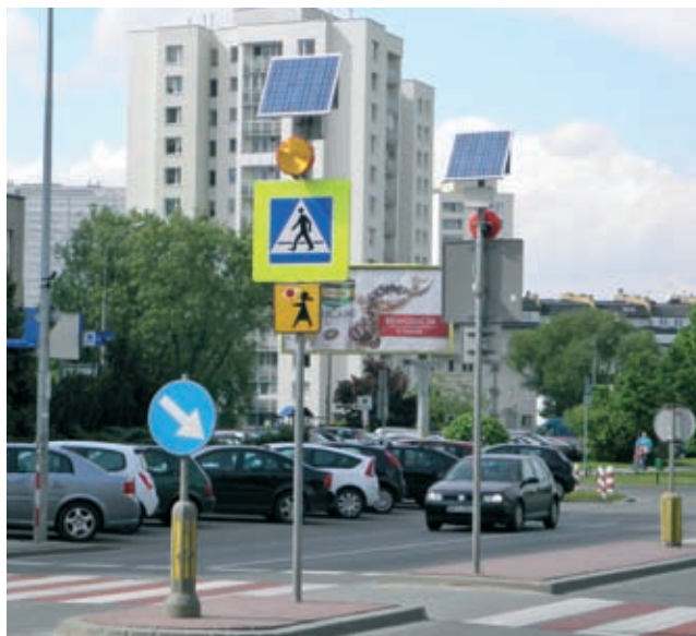
Rys. 2. Moduły fotowoltaiczne zasilające sygnalizatory uliczne
