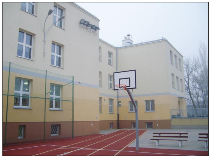
Fot. 3. Oprawy oświetleniowe Horus 400 W zamontowane na ścianie budynku szkolnego
